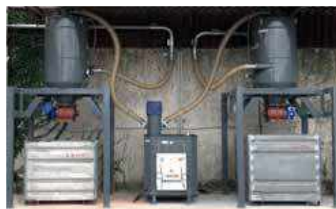
Beispiel: Filter-Vorabscheider mit Zellenradschleuse
